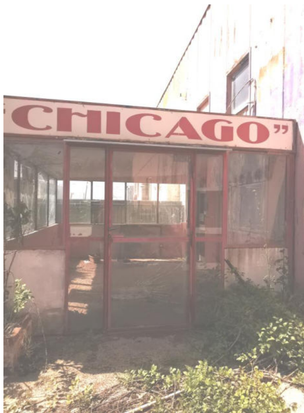
Foto 3: Manufatto da demolire ricadente sulla corte esterna del bene pignorato
